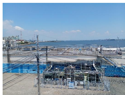
浸出液処理施設
