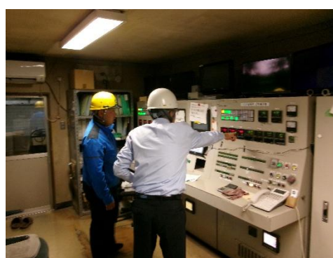
焼却炉のデータ確認
