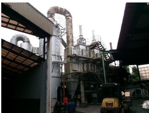
焼却炉の全景
