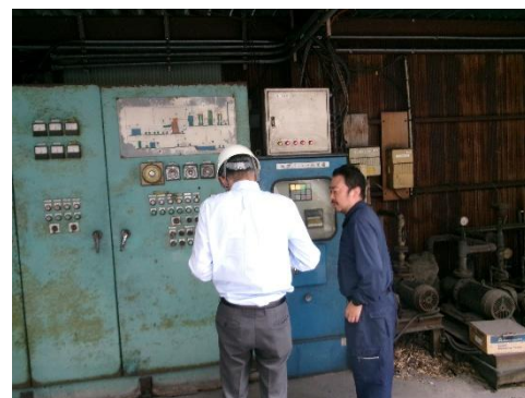
焼却炉のデータ確認
