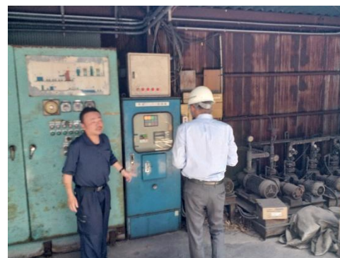
焼却炉のデータ確認
