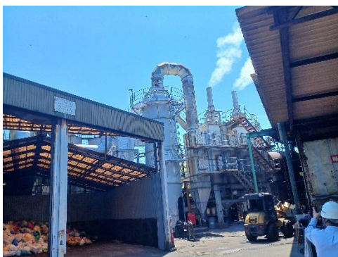
焼却炉の全景
