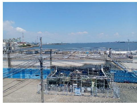
浸出液処理施設
