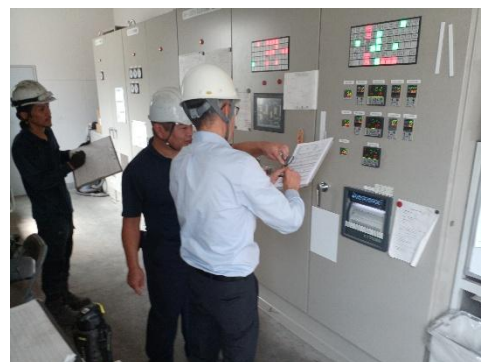
焼却炉のデータ確認
