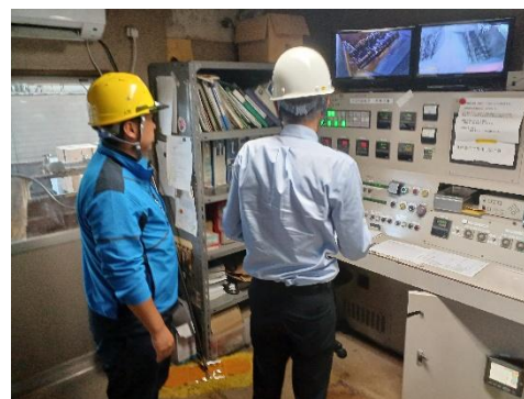
焼却炉のデータ確認
