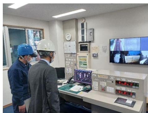
焼却炉のデータ確認
