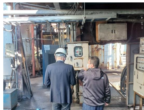
焼却炉のデータ確認
