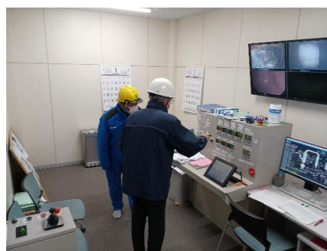
焼却炉のデータ確認
