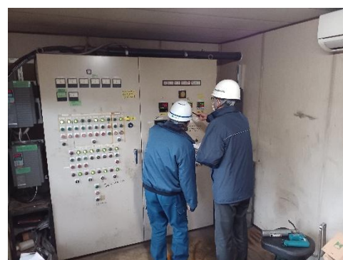
焼却炉のデータ確認
