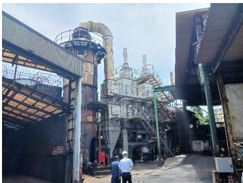
焼却炉の全景
