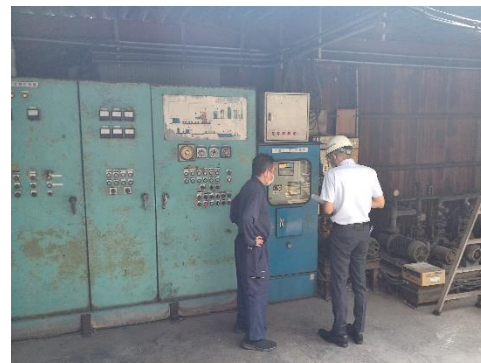
焼却炉のデータ確認
