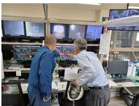
焼却炉のデータ確認
