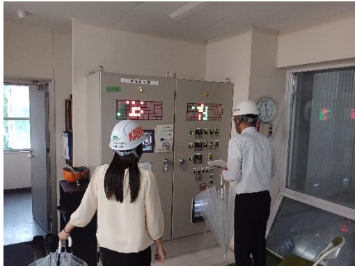
焼却炉のデータ確認
