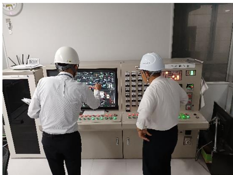
焼却炉のデータ確認
