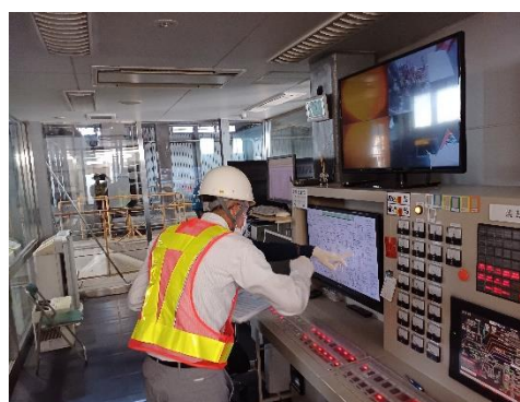
焼却炉のデータ確認
