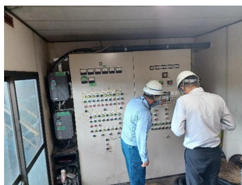
焼却炉のデータ確認
