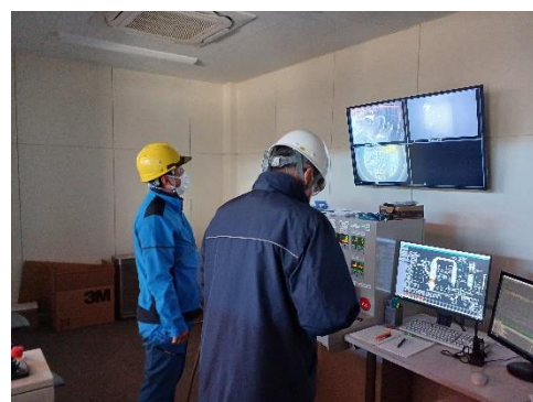
焼却炉のデータ確認
