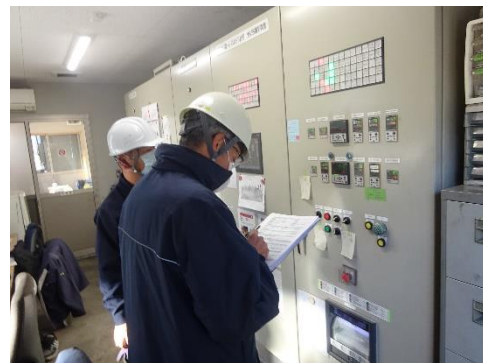
焼却炉のデータ確認
