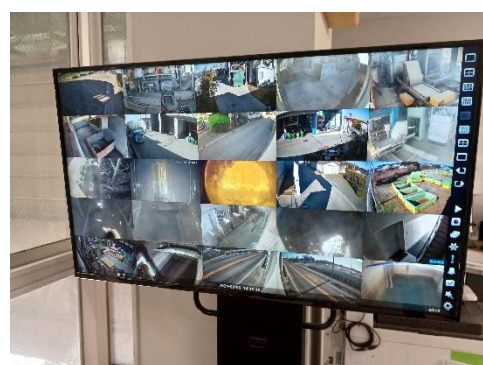
焼却施設監視画面
