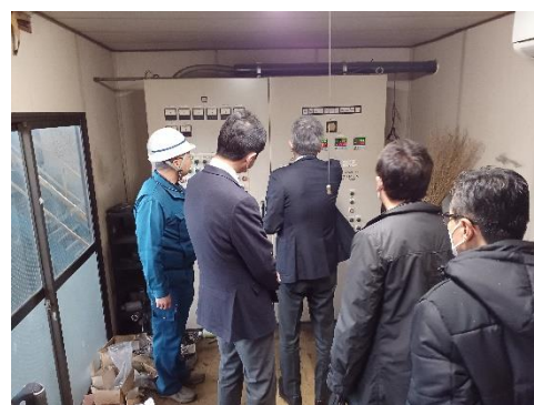
焼却炉のデータ確認
