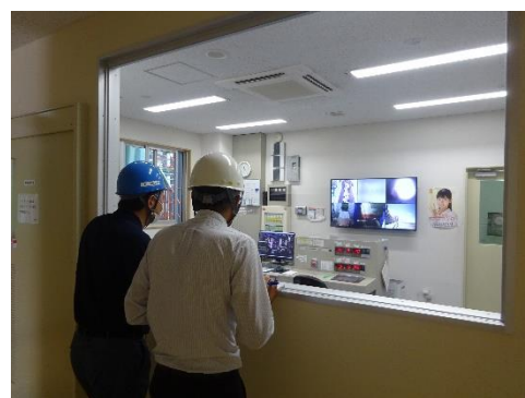
焼却炉のデータ確認
