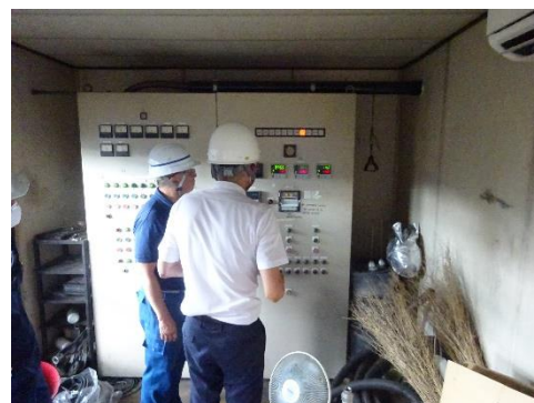
焼却炉のデータ確認
