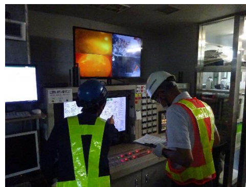
焼却炉のデータ確認
