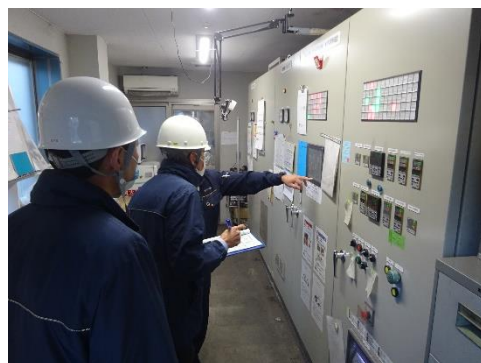
焼却炉のデータ確認
