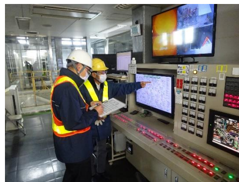
焼却炉のデータ確認
