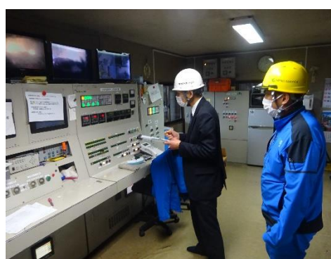
焼却炉のデータ確認
