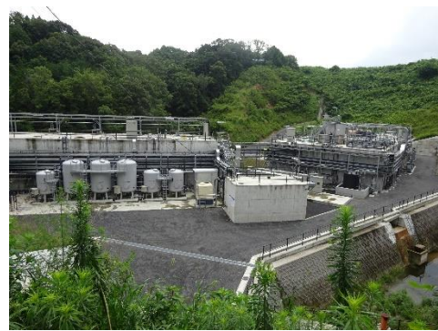
水処理施設全体
