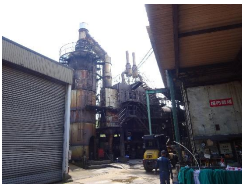
焼却炉の全景
