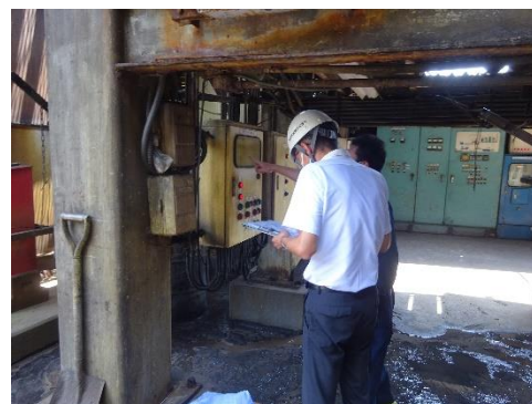
焼却炉のデータ確認
