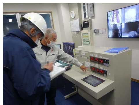
焼却炉のデータ確認
