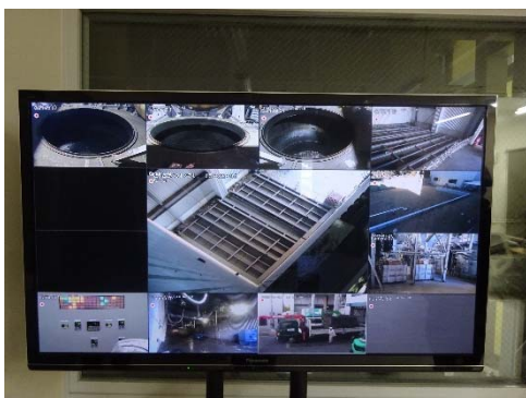
操作室モニター
