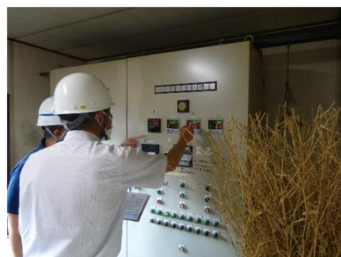
焼却炉のデータ確認
