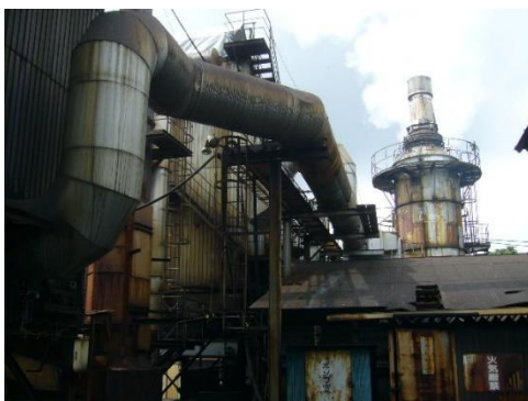
焼却炉の全景
