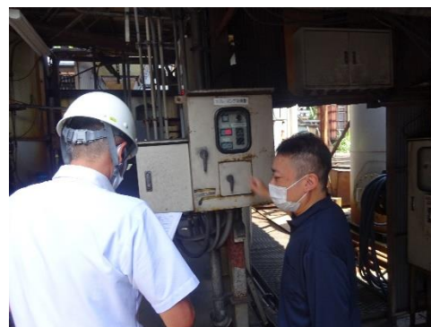
焼却炉のデータ確認
