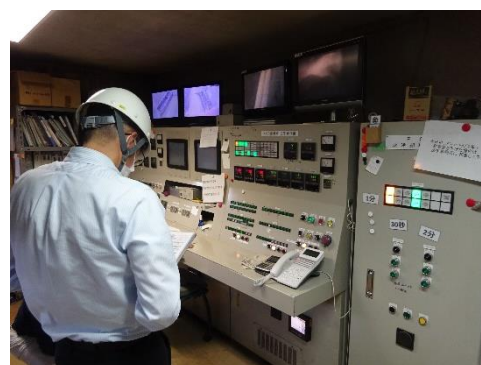
焼却炉のデータ確認
