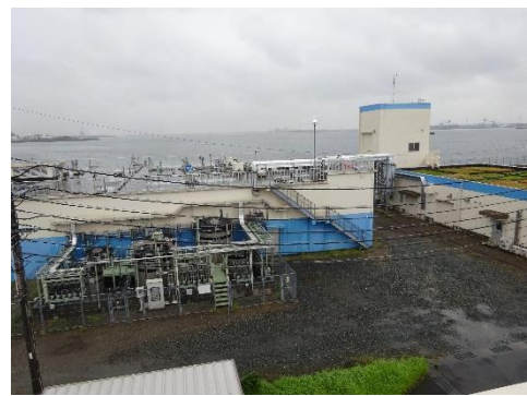
凝集沈殿処理施設
