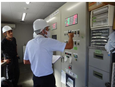
焼却炉のデータ確認
