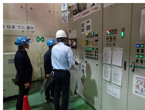
焼却炉のデータ確認
