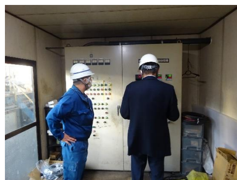
焼却炉のデータ確認
