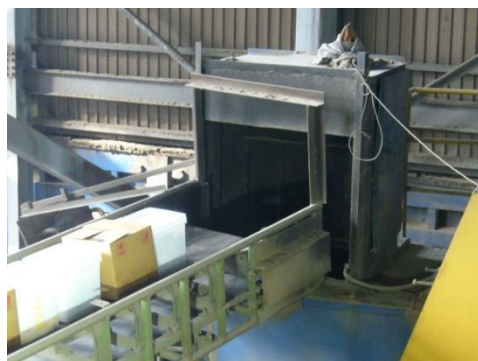
焼却炉投入口
