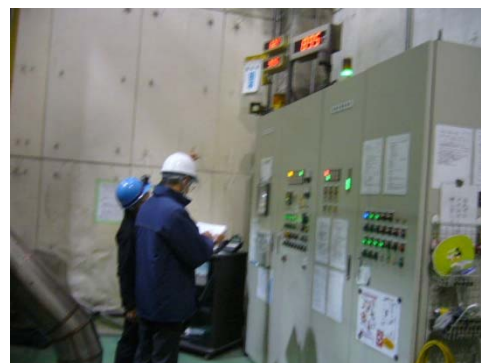
焼却炉のデータ確認
