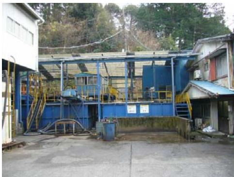
廃液処理施設
