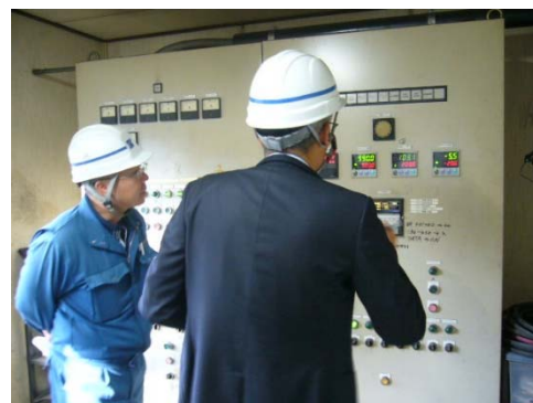
焼却炉のデータ確認
