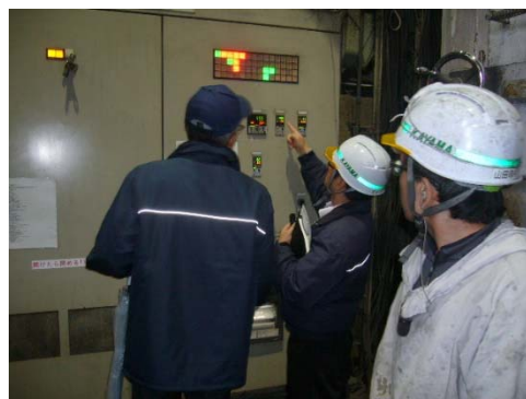
焼却炉のデータ確認
