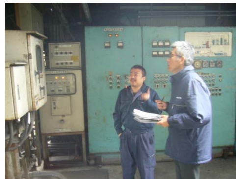
焼却炉のデータ確認
