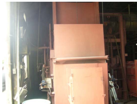
焼却炉投入口
