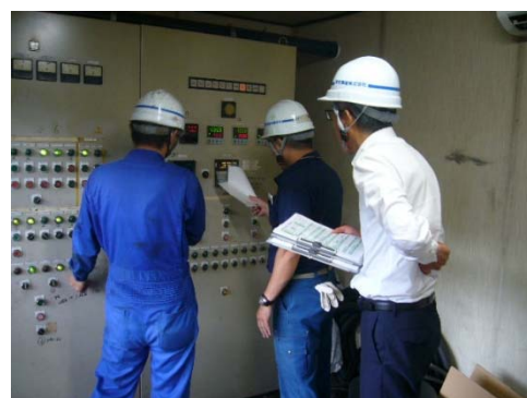
焼却炉のデータ確認
