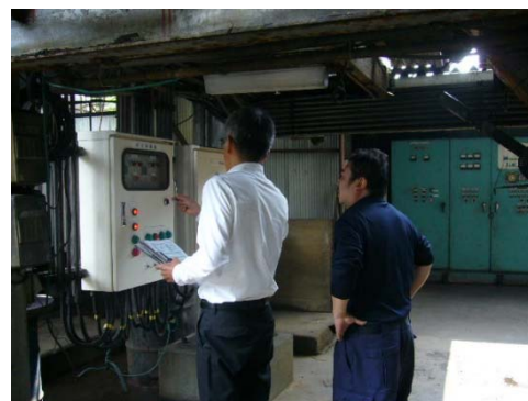
焼却炉のデータ確認
