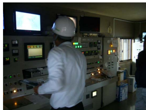
焼却炉のデータ確認
