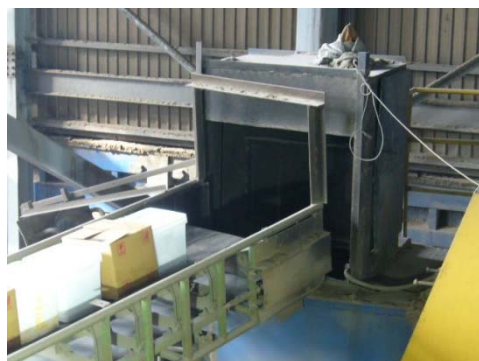
焼却炉投入口
