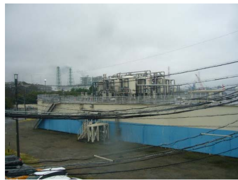
凝集沈殿処理施設
